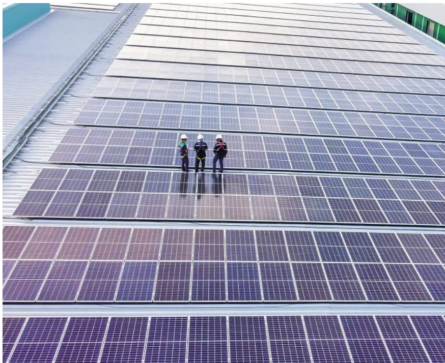
Fotovoltaické panely na střeších skladů se dnes stávají samozřejmostí.
