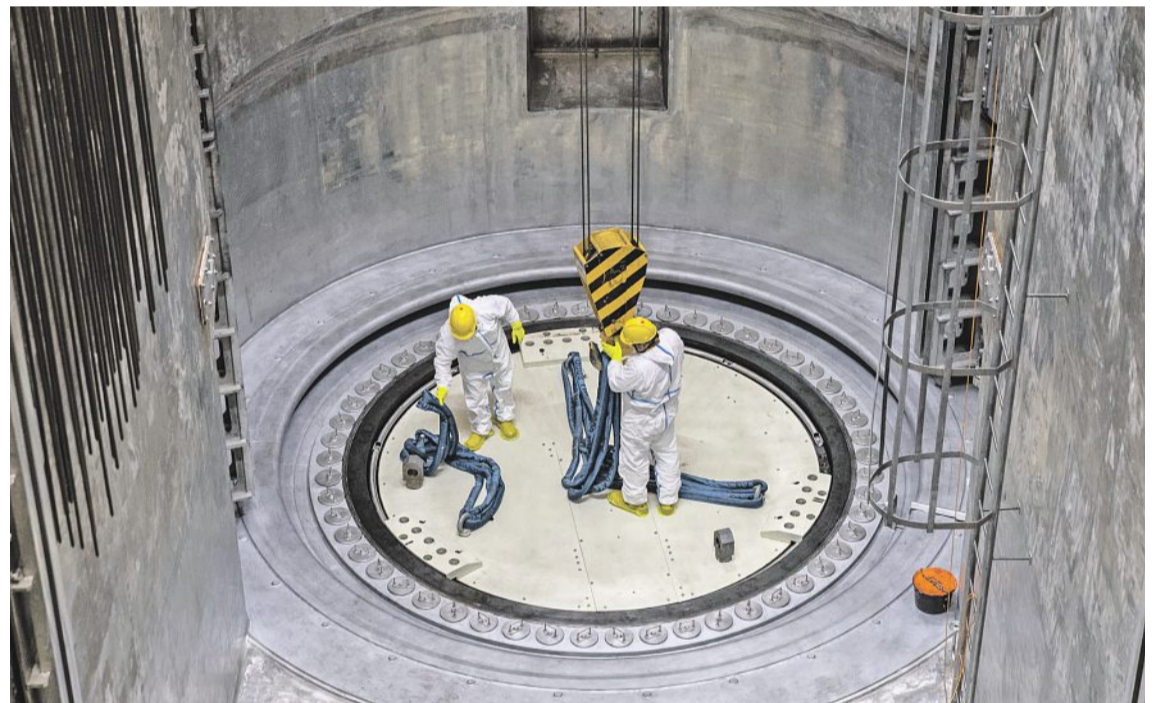
Odstávka v Temelíně Prostor uprostřed reaktorového sálu druhého bloku obvykle vyplňují komponenty tvořící vrchní část reaktoru. Během odstávky je technici ČEZ úplně odstraní. Foto: HN - Václav Vašků
