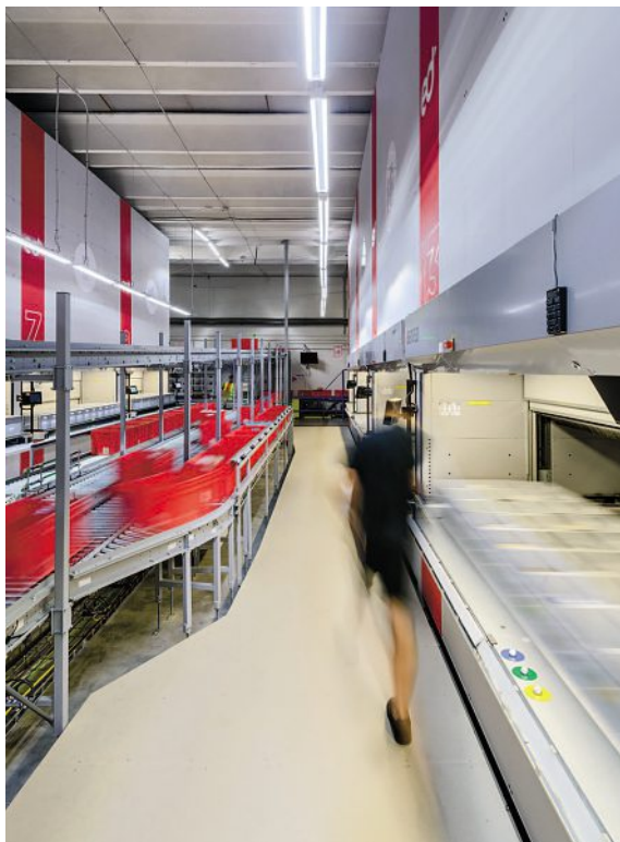
Na dopravníkovou linku jsou napojena čtyři vychystávací pracoviště s 12 pozicemi pro plastové přepravky na vychystávané objednávky.
