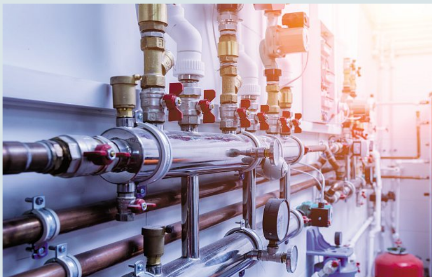
Prodej a pronájem mobilních teplovodních či parních kotelen má na českém trhu velký potenciál. Foto: Free heating
