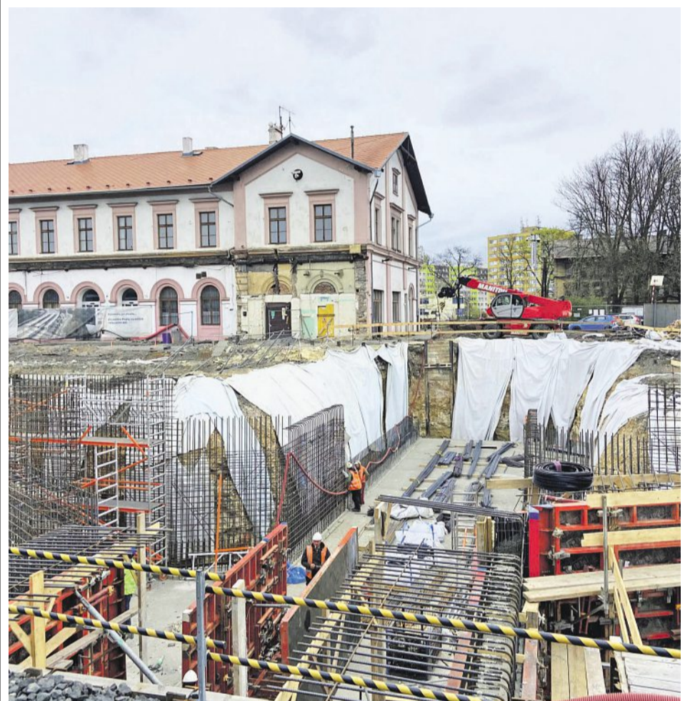
Tvrzení Správy železnic: Kladenské nádraží má i špatné základy. Navzdory tomu budova zatím s přehledem ustála i rozsáhlé stavební práce. Foto: Jan Beránek
