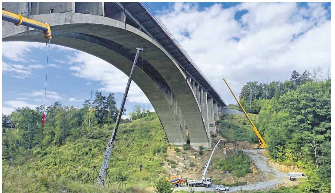
Památná stavba Vedle sebe stojící impozantní oblouky s rozpětím 120 metrů, charakteristický prvek mostu Šmejalka, mají zůstat zachované. Snímek zachycuje podobu z podzimu 2022, před začátkem oprav. Foto: HN – Jan Beránek
