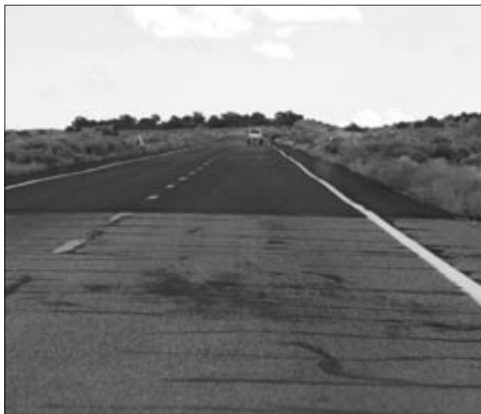
Úsek s běžnou asfaltbetonovou obrusnou vrstvou porušenou trhlinami (v popředí) a s gumoasfaltovou obrusnou vrstvou (v pozadí).
