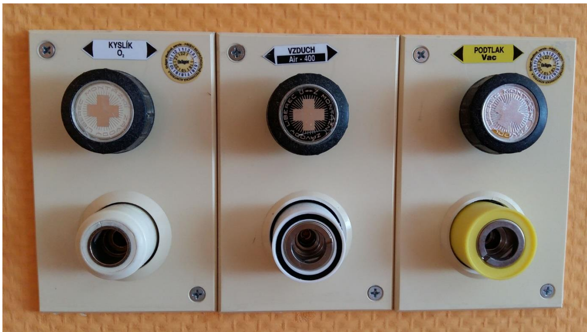
Centrální rozvod plynů
