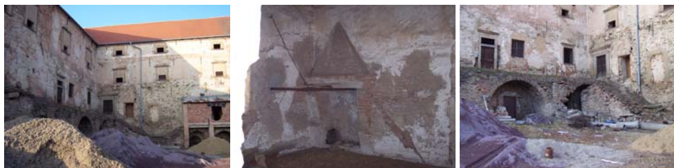
Obr. 2.10: Ukázky stavebně technického stavu historických objektů - Tvrz Horní Dunajovice
