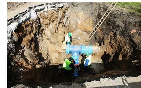
Havárie potrubí nechala 30 tisíc Pražanů bez dodávky vody. | foto: MAFRA - Dan Materna
