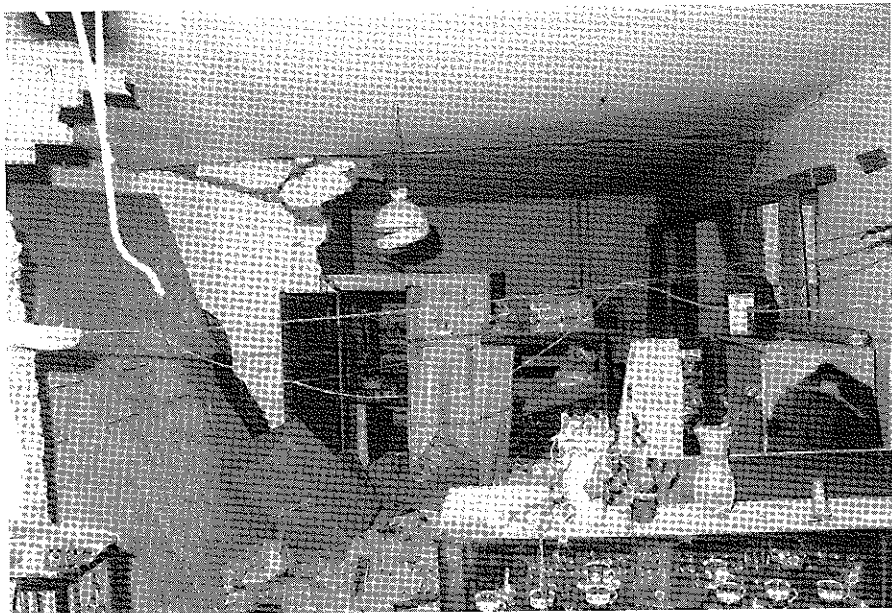
Obr. 50.2: Zdemolovaná místnost bytu po výbuchu zemního plynu.
