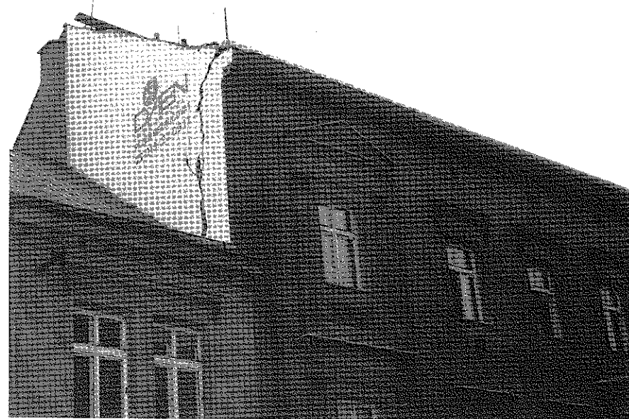
Obr. 50.1: Porušení konstrukce domu po výbuchu zemního plynu v bytě
