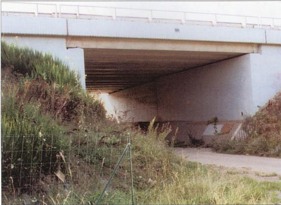
Foto 12 – Podstatný vliv na funkčnost oplocení má také napojení oplocení na mostní konstrukce. Při nedokonalém napojení se zvěř v těchto místech rovněž snadno dostává do prostoru mezi plot a dálnicí (D5)
