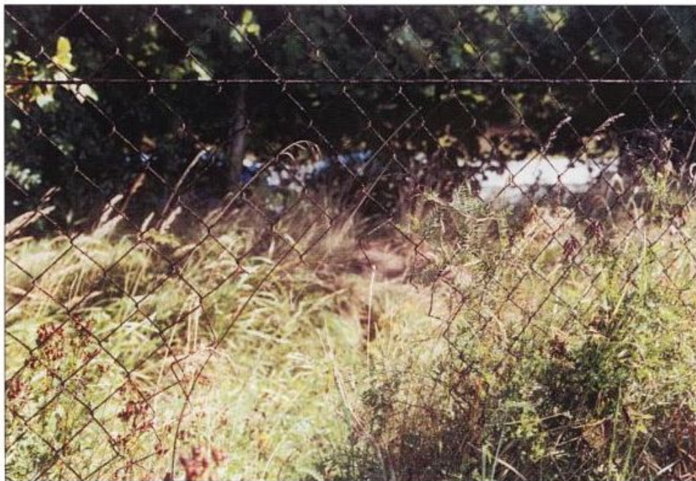
Foto 11 – Dálniční oplocení – pokud je oplocení umístěno až vně zeleného pásu na zářezích a náspech, zvěř se četnými otvory dostává do zaplaceného prostoru (D1)
