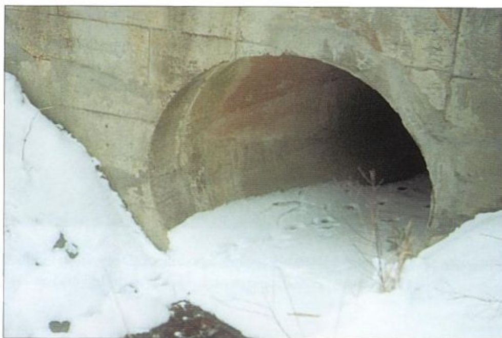
Foto 7 – Trubní propustek – tento typ může sloužit jako průchod pouze pokud není protékán vodou nebo při zámrazu v zimním období
