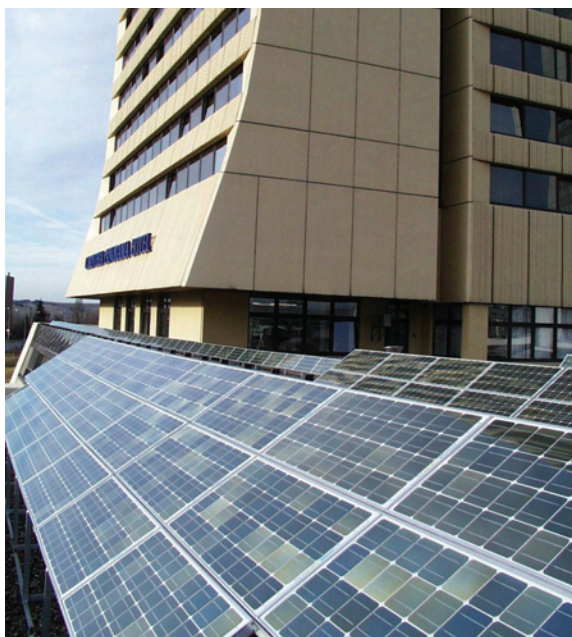
Fotovoltaický systém na budově hotelu Corinthia Panorama na Pankráci
