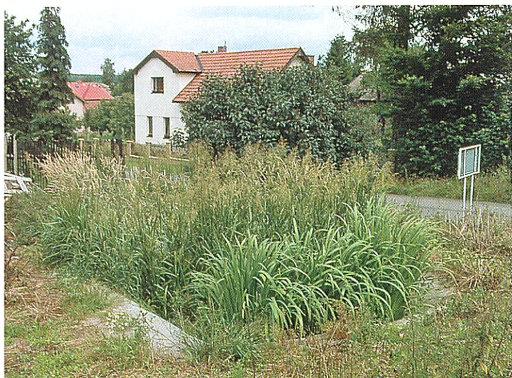
Foto 16 Domovní kořenová čistírna v Kyjově u Havlíčkova Brodu. Foto J. Vymazal.
