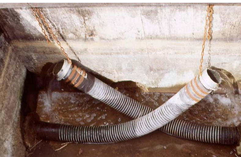
Foto 10 Regule výšky vodní hladiny ve filtračním poli pomocí flexibilních hadic zavěšených na řetízcích na KČOV Spálené Poříčí. Foto J. Vymazal.
