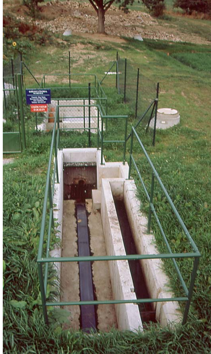
Foto 7 Předčištění (lapák písku, česle a šterbinová nádrž) na KČOV Petrovice u Havlíčkova Brodu. Foto J. Vymazal.
