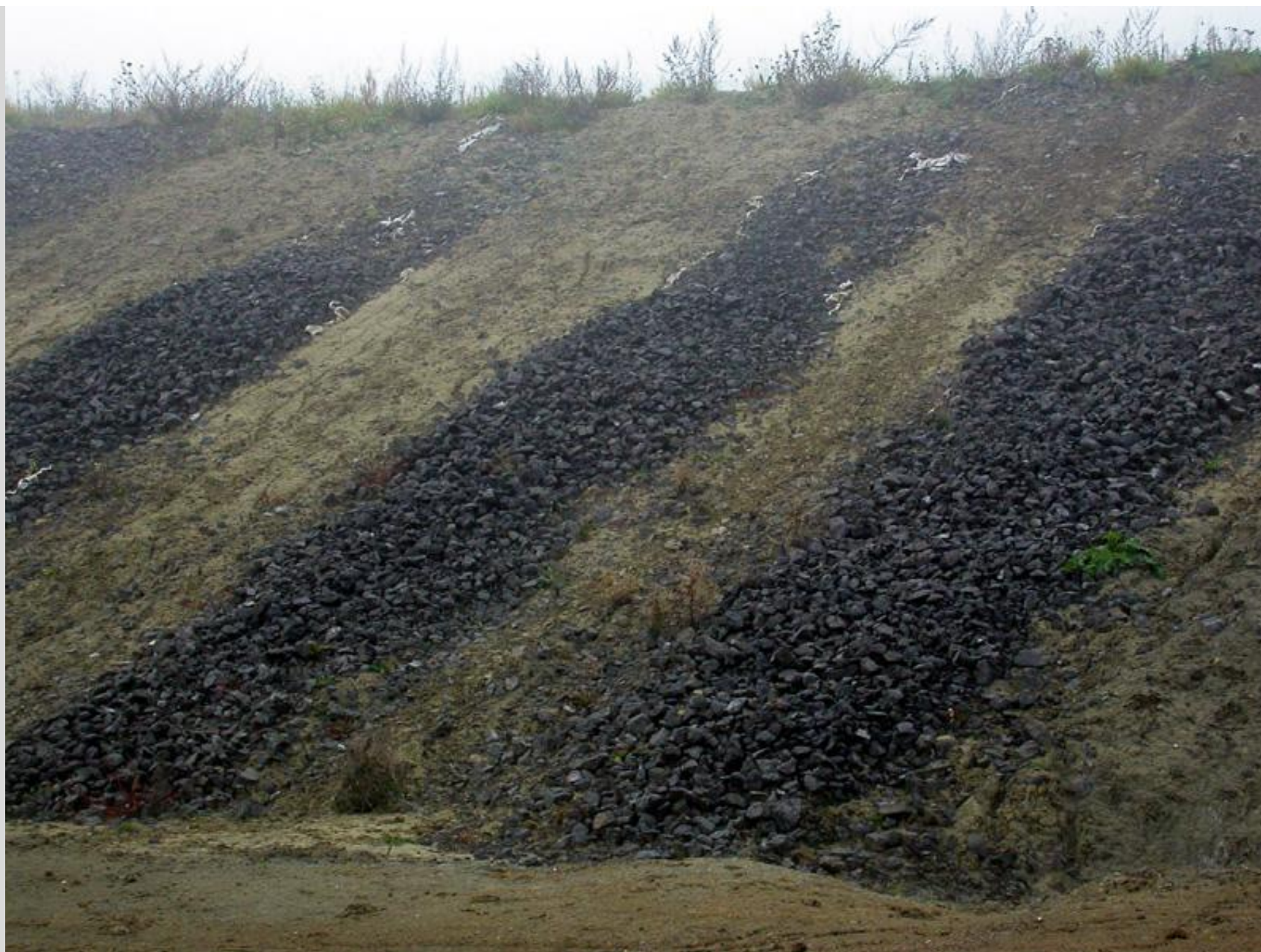
Fotografie sesuvů na dálnici D8-0805 v km 56,5 (2010 až 2012)
