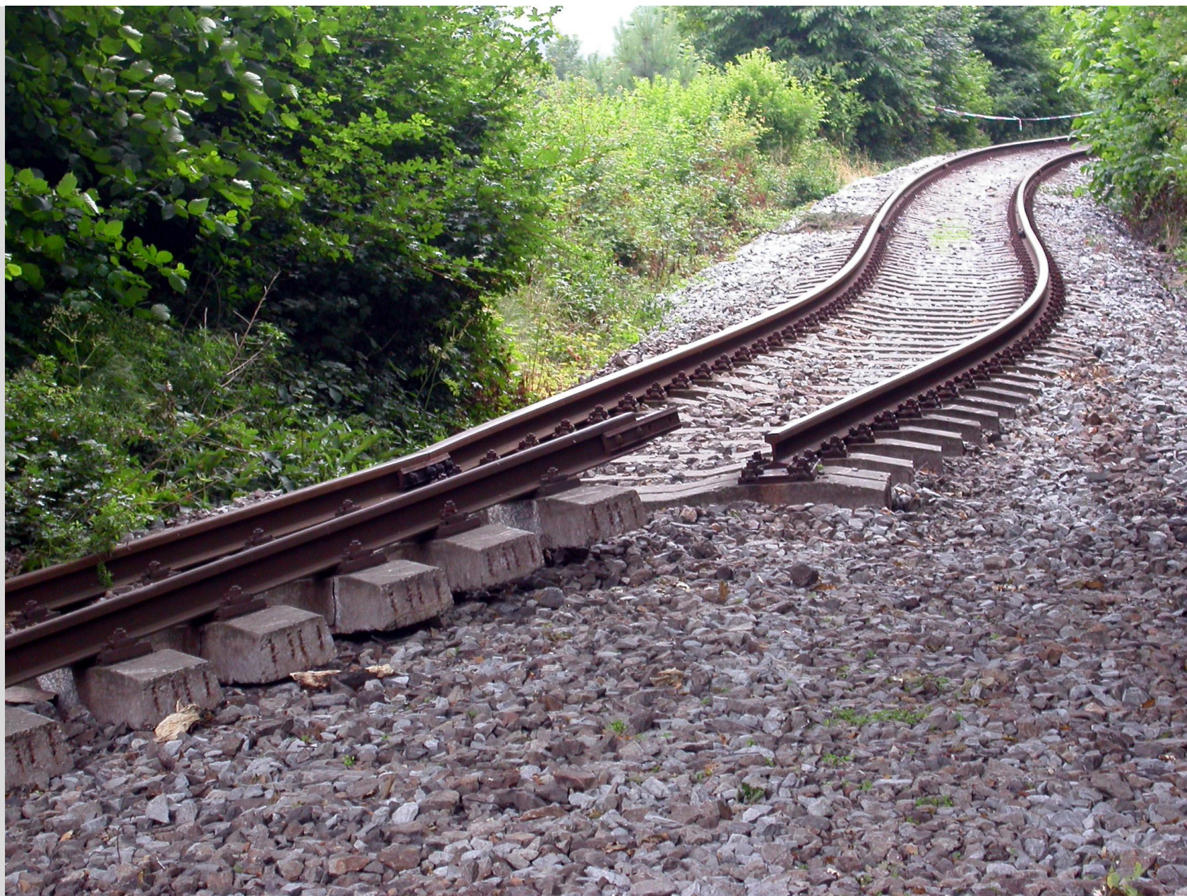
Fotografie sesuvu v km 56,3-56,5 (6. 7. 2013)
