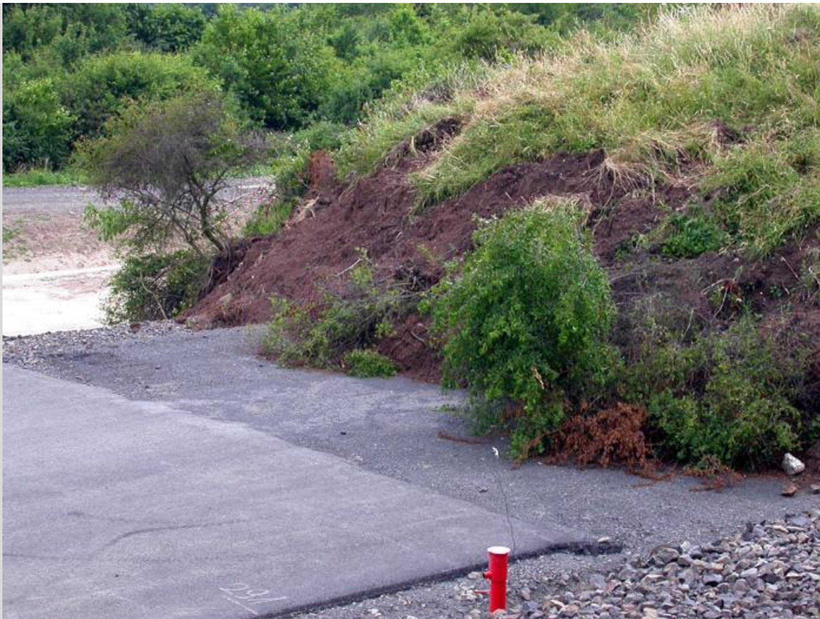
Fotografie sesuvu v km 56,3-56,5 (6. 7. 2013)
