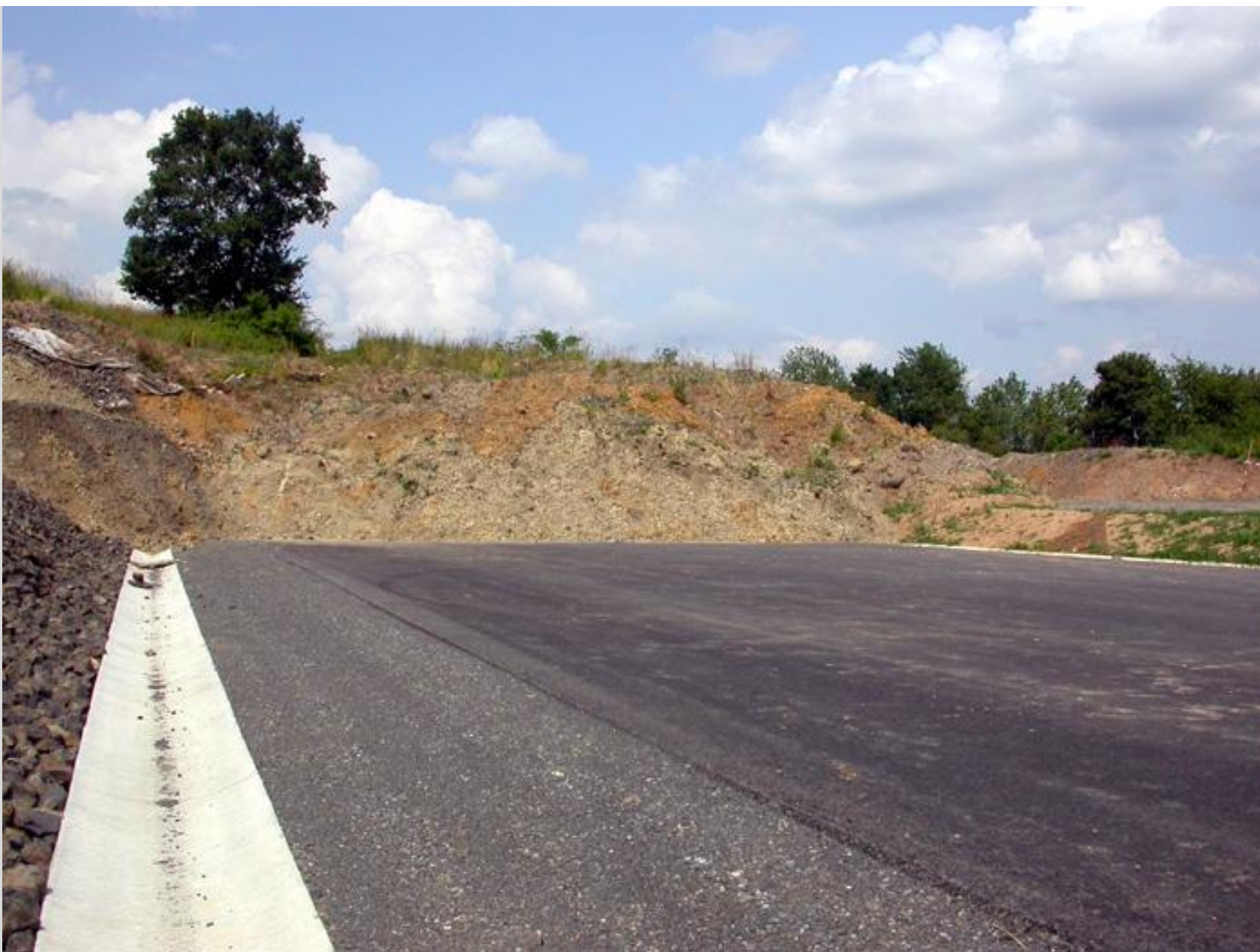
Fotografie sesuvu v km 56,3-56,5 (6. 7. 2013)
