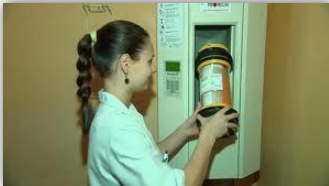
Vkládání přepravního pouzdra do stanice potrubní pošty
