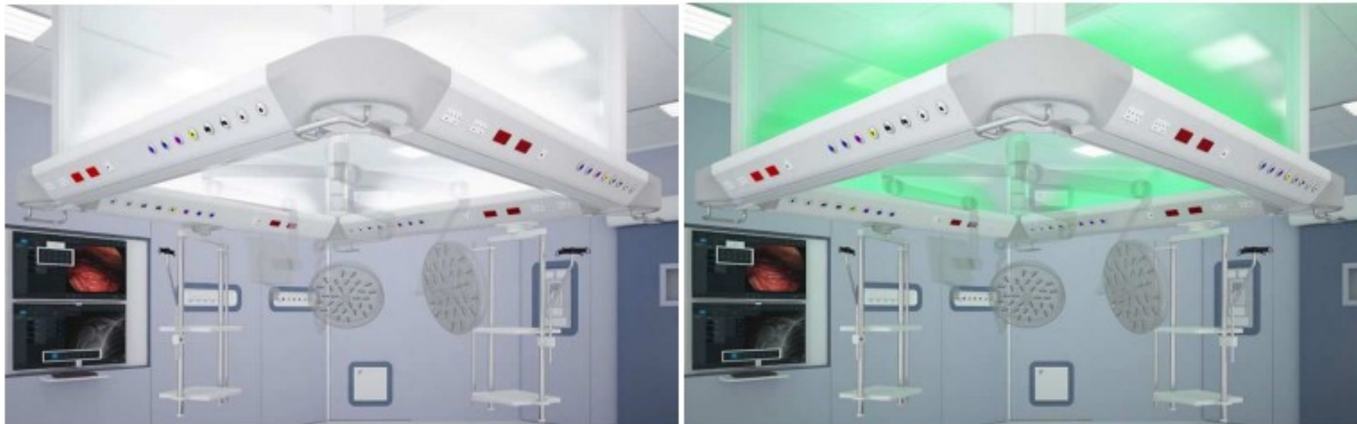
Instalační zdrojové mosty
