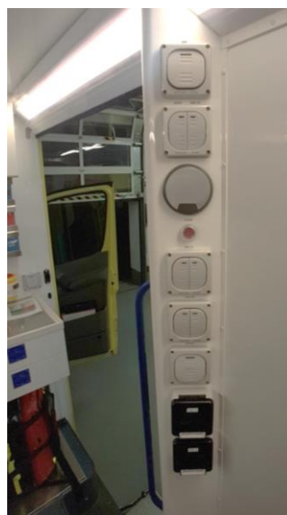
Obrázek 19 Vypínače a elektrické zásuvky
