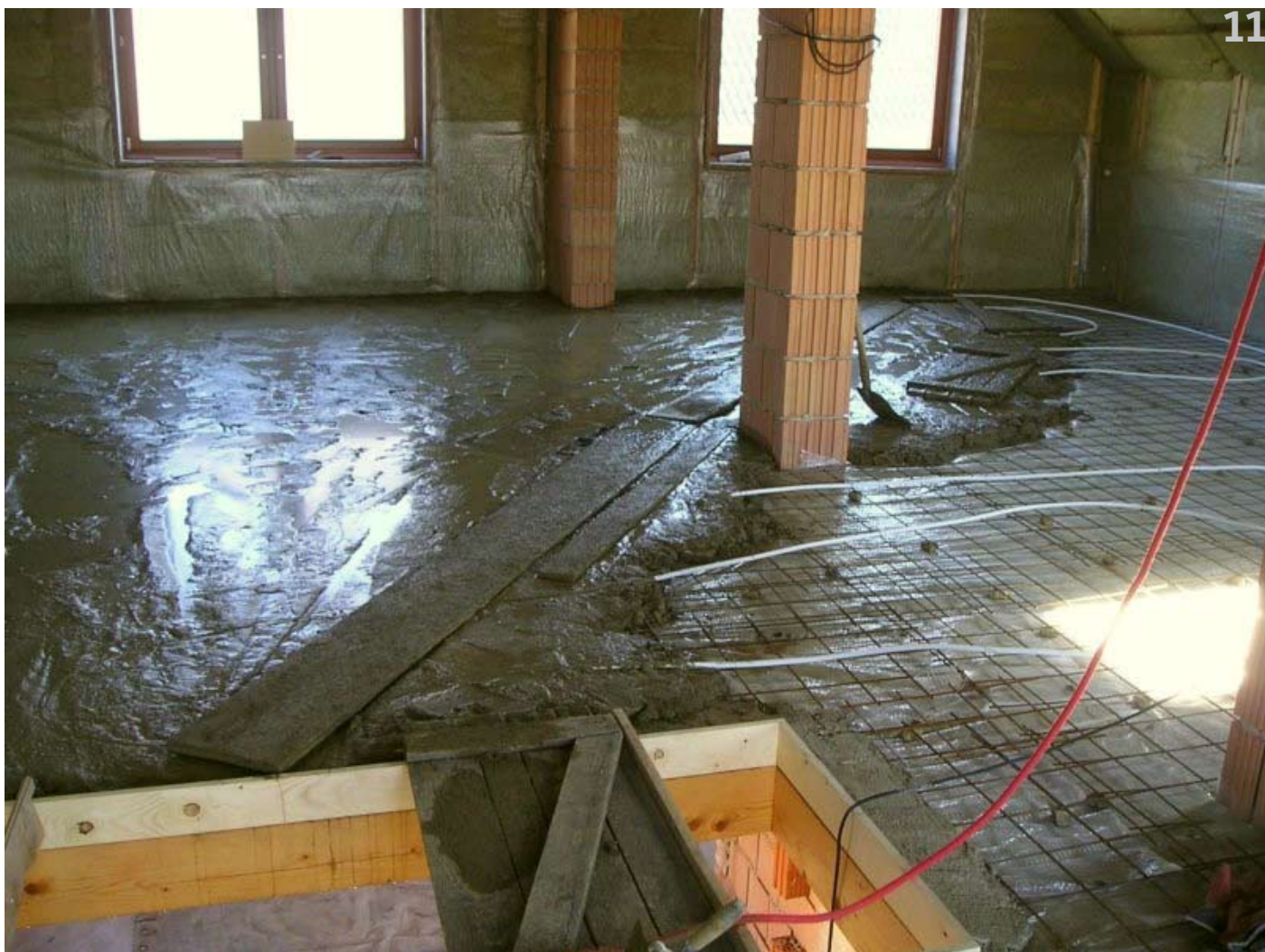
Obr. 16. Betonáž podlahové desky s podlahovým topením v 1. poschodí. Vzdálenost hadic je asi 1 metr. I při tak nízké hustotě hadic se místnosti 1. poschodí spolehlivě vytopí vodou o teplotě 30 °C.
