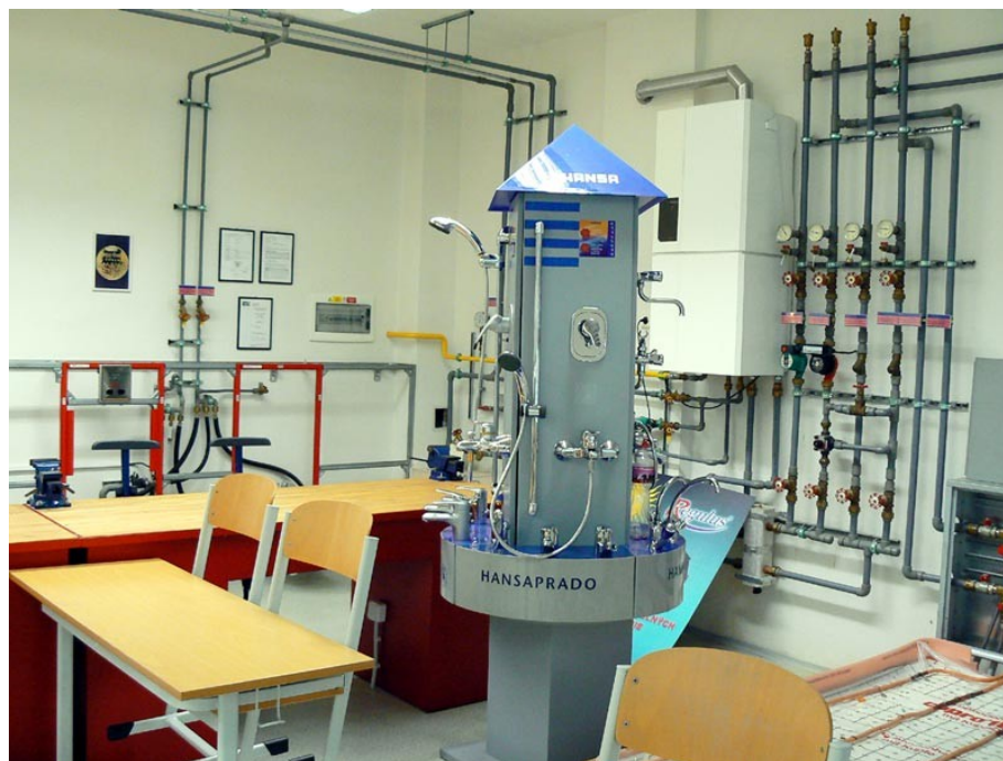
Obrázek č. 5: Ukázkou odborné učebny pro výuku oboru instalatér, střední škola polytechnická, Jílová, Brno ( www.jilova.cz/index.php )
