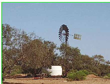
High Way Bore se říká této sestavě k čerpání subartézské vody, která se skládá z větrného vodního čerpadla a nádrže na načerpanou vodu. Celek slouží k napájení dobytka a vytékající voda zavlažuje celou oblast.
