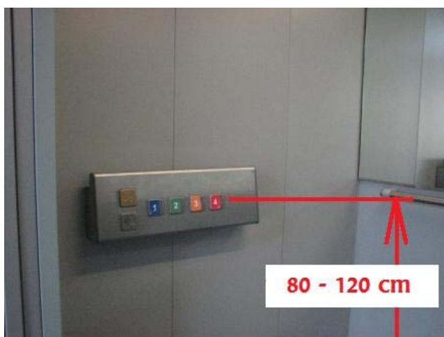
Obr.: ovládací panel ve výtahu
