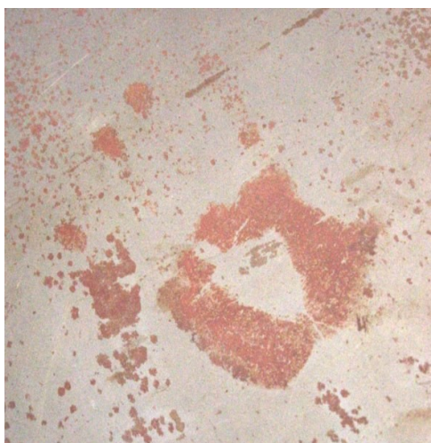
Koroze železa vlivem chloridů z potu
