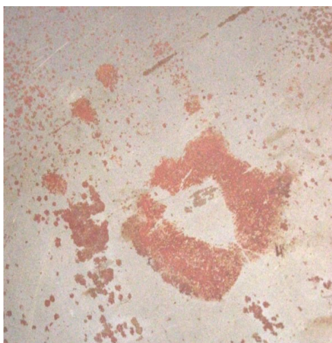
Koroze železa vlivem chloridů z potu
