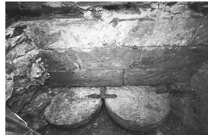
Karlův most: Průzkumná sonda u pilíře č. 9 s mlýnskými kameny tvořícími základovou spáru tohoto pilíře
