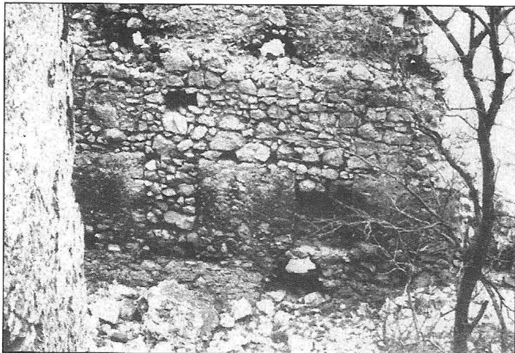
50. Gotické cimbuří v pozdějších obdobích zazdívali, na Plaveckém hradě přitom došlo i ke zvýšení hradby.
