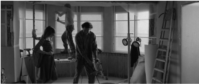
Figuur 6 De verbouwing: Rogier aan het werk met de Poolse bouwvakkers, onder het goedkeurend oog van Małgosia
