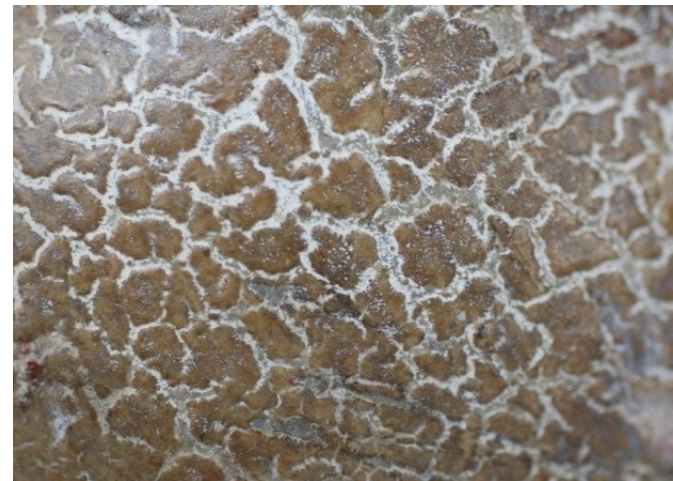
Krakely malby na dřevě vzniklé nesprávnou technologií malby, foto I. Fogaš
