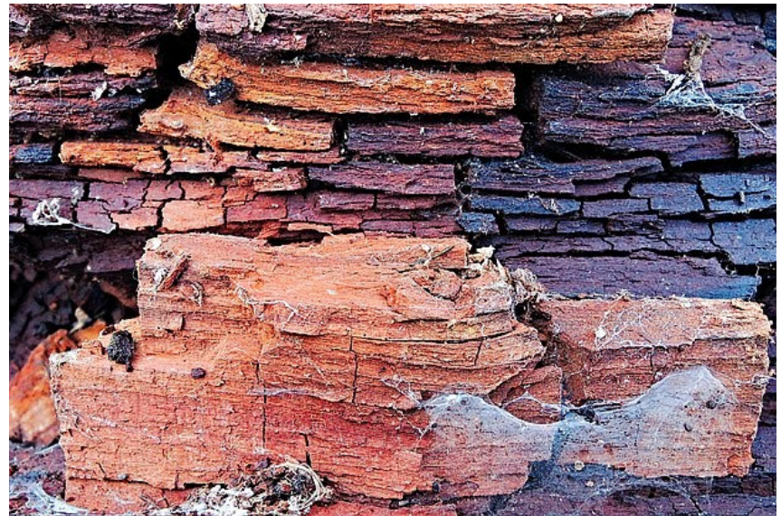
Dřevo poškozené dřevomorkou – kostkovitý tvar
