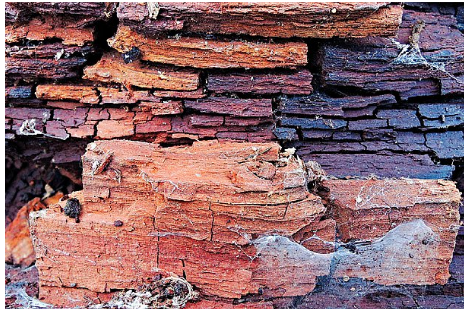
Dřevo poškozené dřevomorkou – kostkovitý tvar
