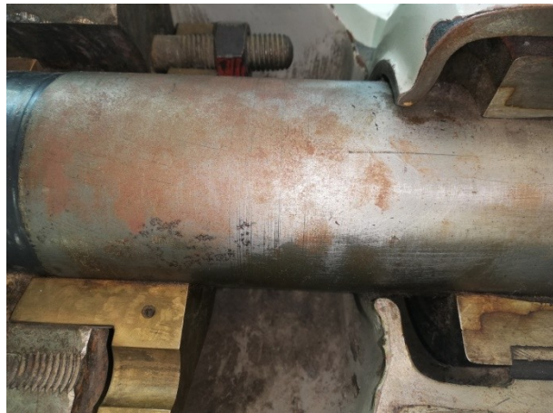
Slabé vrstvy rzi vlivem lokálního znečištění povrchu
