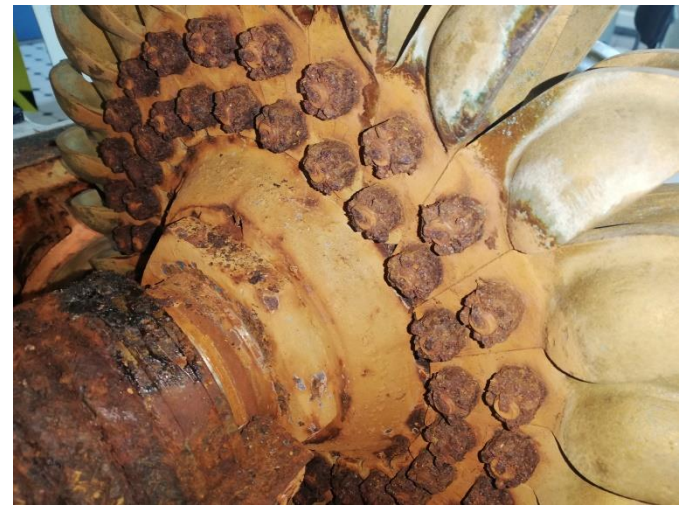
Objemné korozní vrstvy vlivem zvýšené vlhkosti
