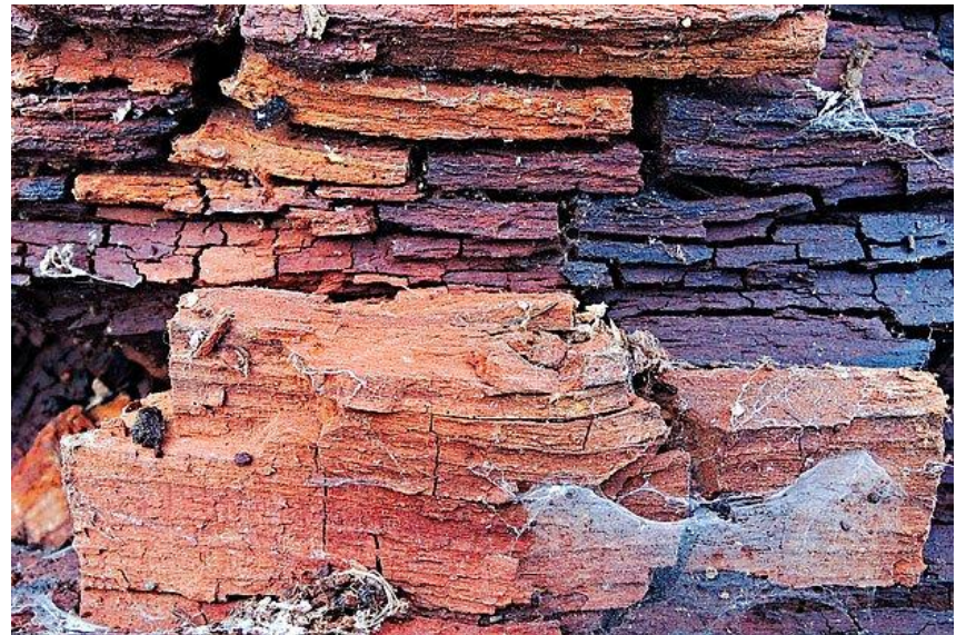
Dřevo poškozené dřevomorkou – kostkovitý tvar
