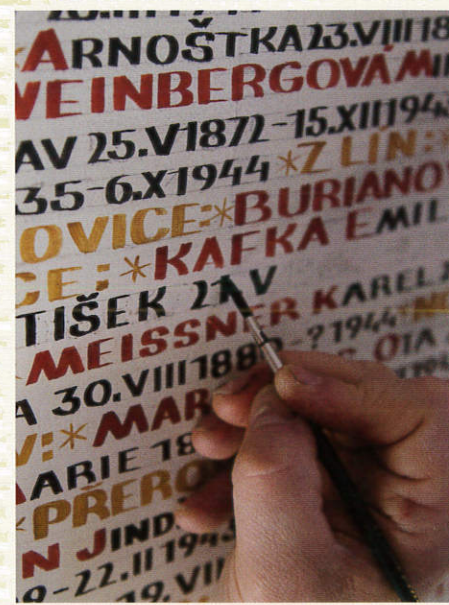
Obnova poškozených nápisů Památníku obětí šoa z českých zemí v Pinkasově synagoze po povodni v roce 2002
