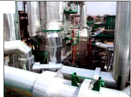
Kyselina sírová je vyráběna na nejmodernějším zařízení
