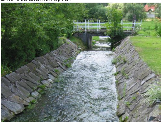
Souvislá úprava dna i břehů kamennou dlažbou
