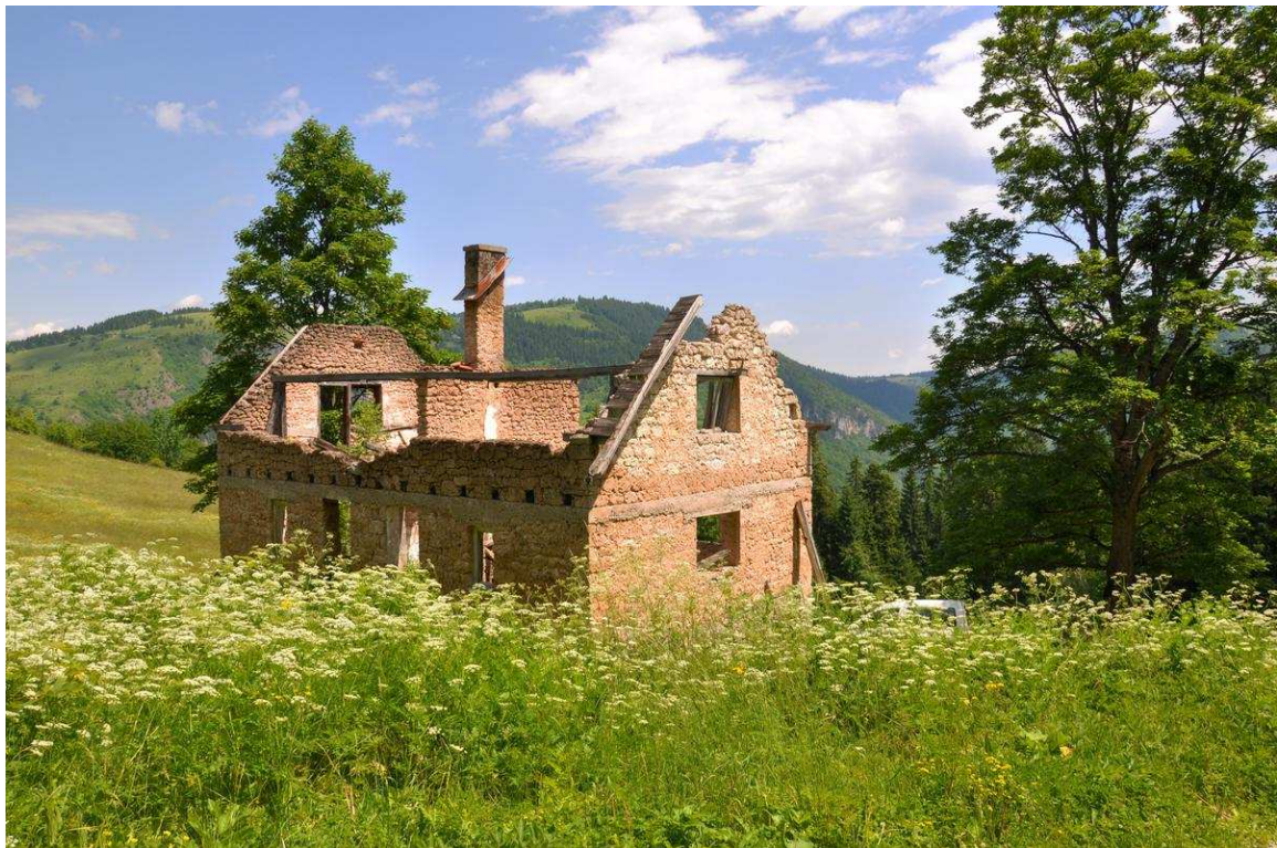
Obr. 8 Opuštěný dům v pohoří Bukovik
