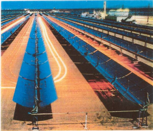
Největší současná sluneční elektrárna SEGS VIII v Kalifornii s výkonem 30 MW má v naklápěcích rámech celkem 1,5 miliónů zrcadlových desek.
