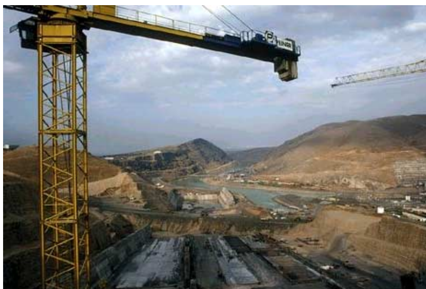
Obrázok 13.8 Výstavba vodnej nádrže je vždy výrazný zásah do krajiny. Pohľad na časť staveniska priehrady „Tri sútesky“ na rieke Jang ěc-tiang v Číne
