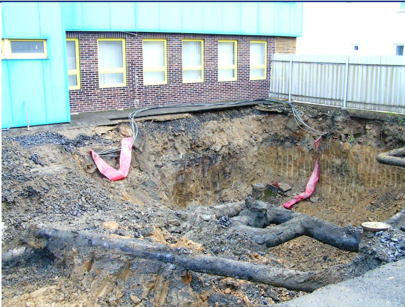
Sanační výkop v blízkosti admin.budovy-obnažení plynového potrubí
