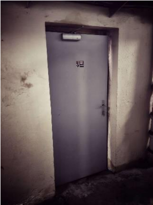
Požární dveře po požáru
