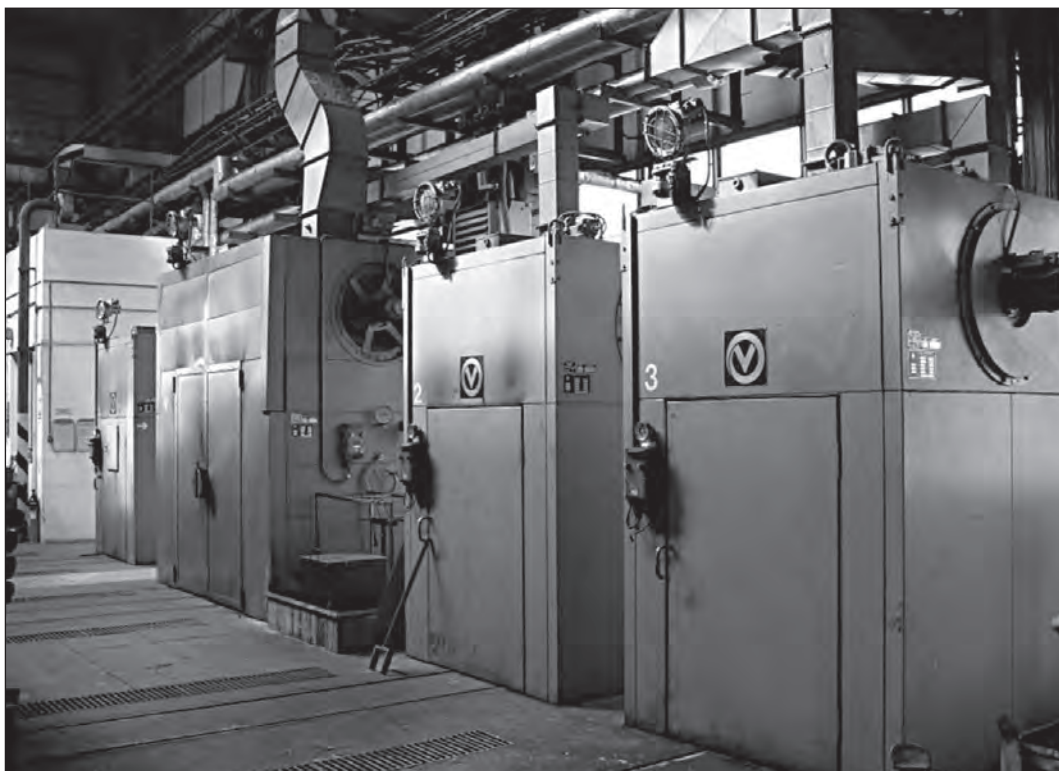
Obr. 5 Sušící a vypalovací pece
