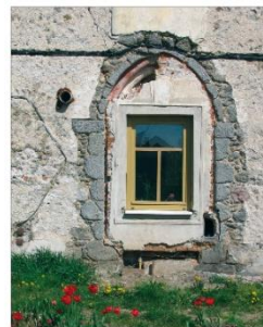
Obr. 2. Částečně odkrytý raný gotický portál.
