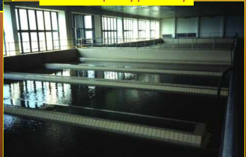
Pitná voda úpravny pitné vody
