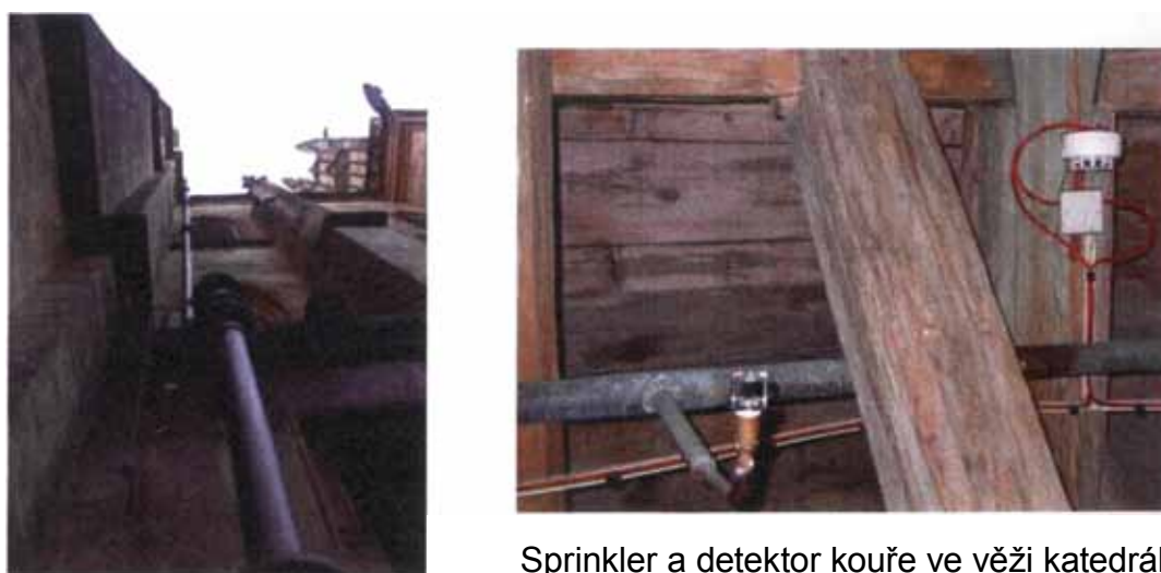
Suché potrubí připevněné ke stěně katedrály sv. Víta.
