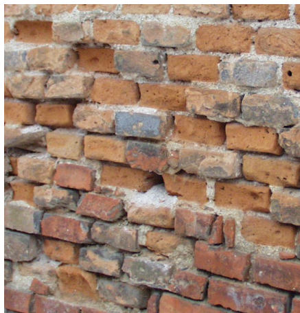
Neomítnuté zdivo porušené mrazem
