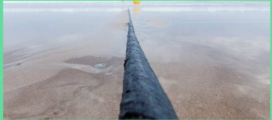
komunikační kabel vedoucí pod oceán
