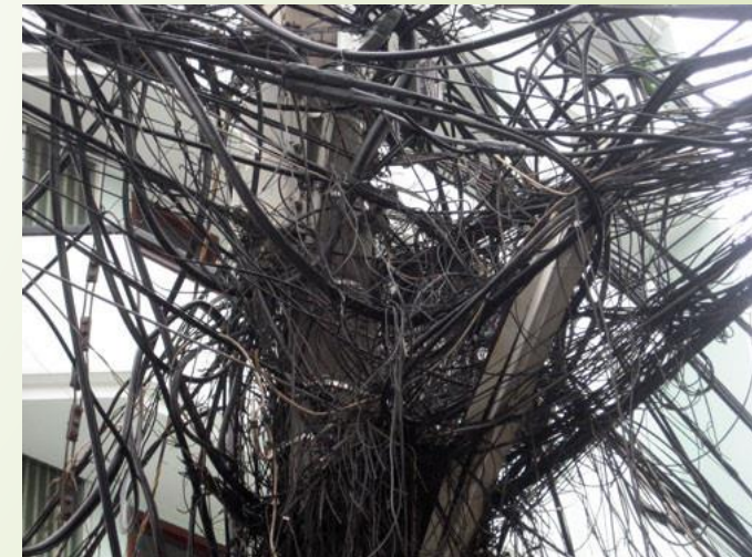
Různé typy kabelů na sloupu, Vietnam
