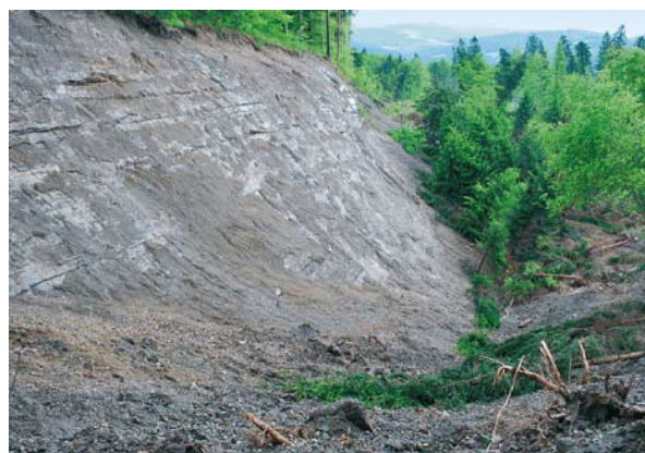
Až 30 m vysoká odlučná stěna sesuvu. Foto J. Klimeš
